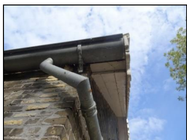
Figuur 36. Ruimte tussen dakgoot en daklijst bij oude schuur (nummer 4).
