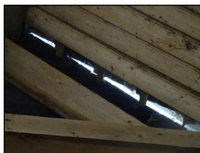
Figuur 26. Zicht vanuit de schuur op het dakbeschot en de dakpannen met openingen naar buiten.
