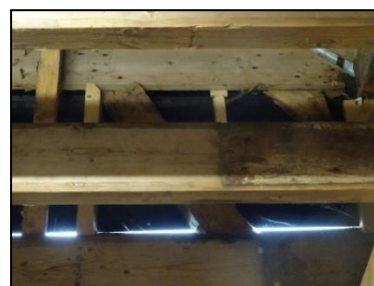
Figuur 38. Ruimte onder de dakrand en opening naar onder de betimmering zichtbaar bij de nieuwe schuur (nummer 5).
